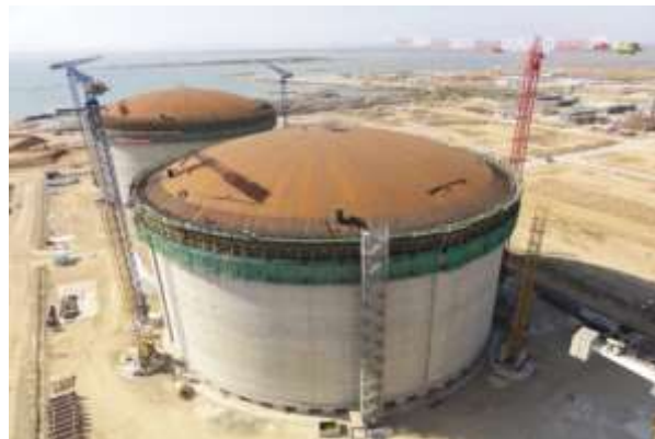
山东LNG接收站 · 2012
